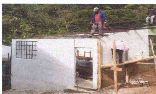
Foto 4: PAREDES DE LA COCINA DEL LADO ESTE QUE SE ESTA REPELLANDO EN SU INTERIOR Y EXTERIOR.
